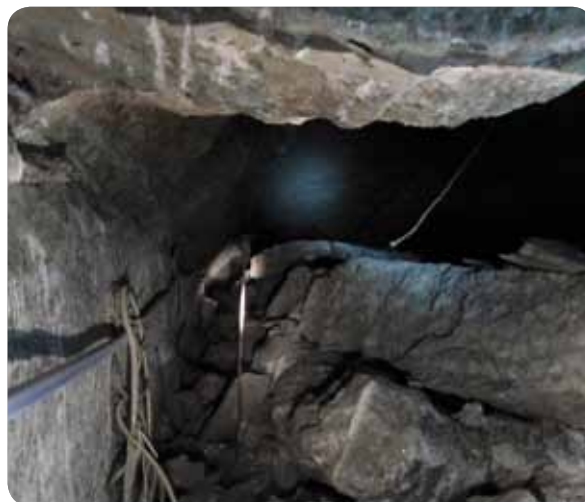
Les éboulements dans le bloc 15
