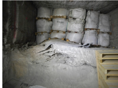
Exemple de big-bags (gros sacs de déchets) coincés par le soulèvement du mur (= du sol) de la galerie de stockage
