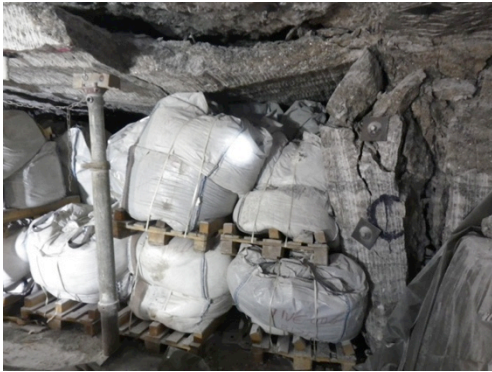
Exemple de dégradations observée dans l'allée 1 du bloc 12 rendant dangereux le déstockage
