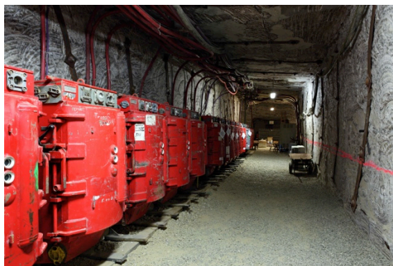
Photo 6 : salle électrique à proximité du stockage
