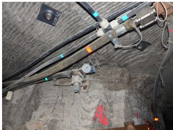
Figure 12 : Installation d'inertage à l'azote en allée de bloc
