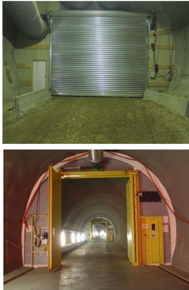
Figure 9 : Porte palière de compartimentage (en haut) – porte coulissante « type kiosque » (en bas)
