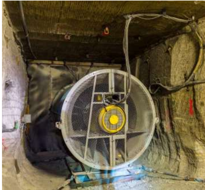
Figure 28 - Vue du ventilateur ES1
