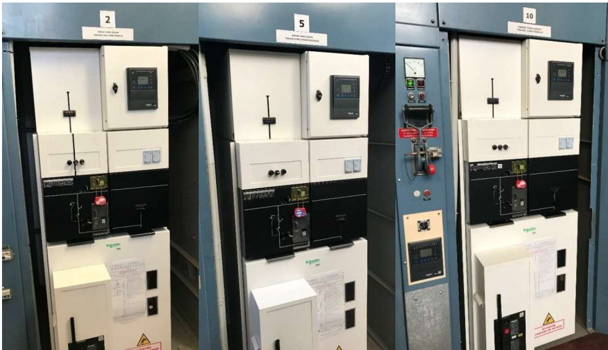
Figure 56 - Cellules n° 2, 5 et 10 du poste 5 kV de surface qui assurent l'alimentation électrique du fond
