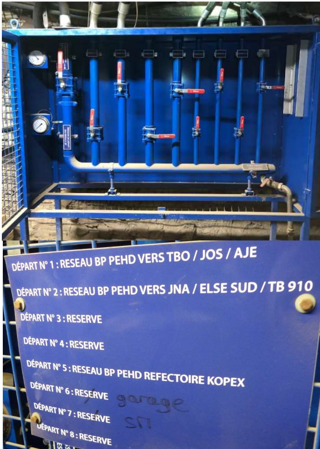
Figure 35 - Tableau secondaire de distribution du réseau d'eau industrielle BP
