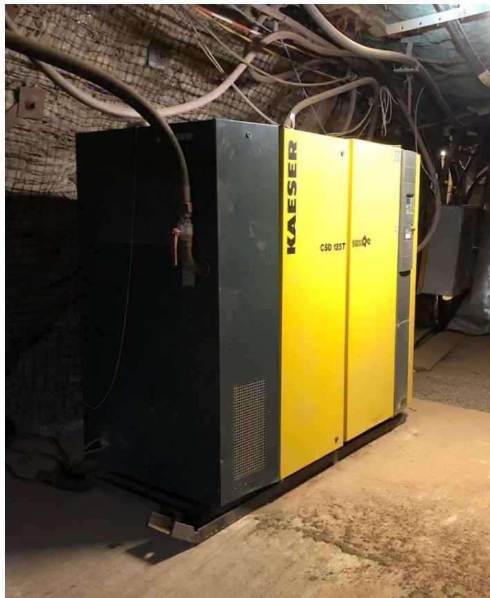
Figure 46 - Photographie du compresseur localisé en souterrain dans la recoupe fluide
