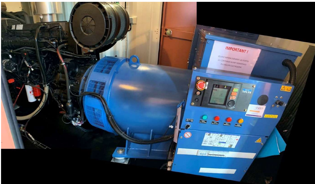
Figure 53 - Groupe électrogène de secours
