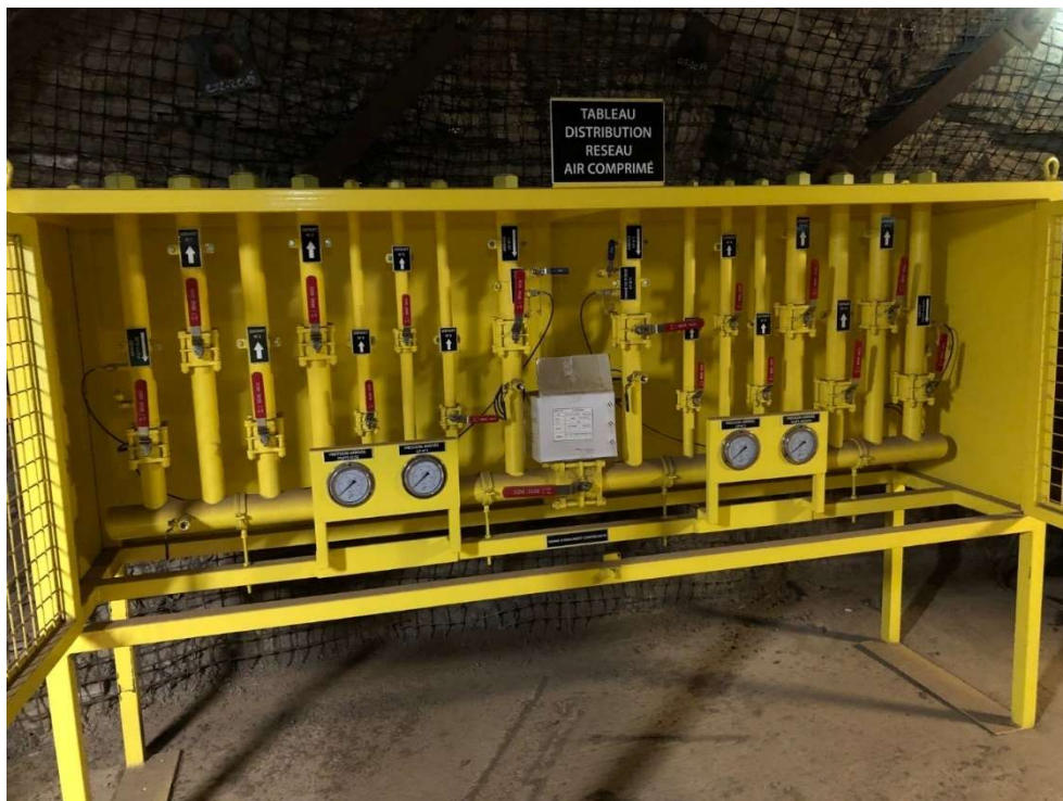
Figure 50 - Tableau de distribution localisé dans la recoupe fluide en souterrain
