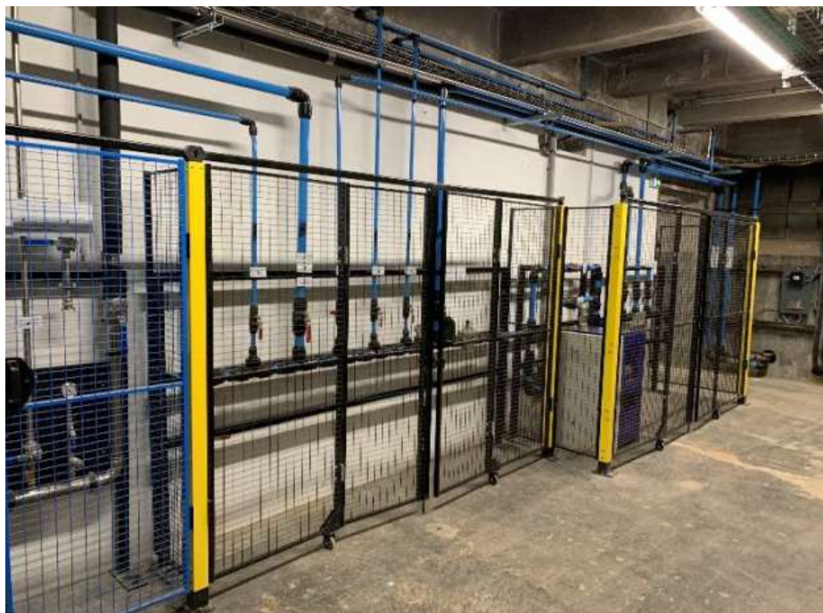
Figure 48 - Tableau de distribution de l'air comprimé localisé dans le sous-sol du chevalement Else
