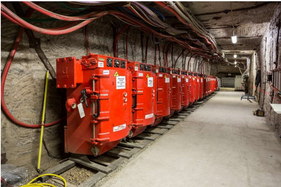
Figure 57 - Station électrique souterraine principale
