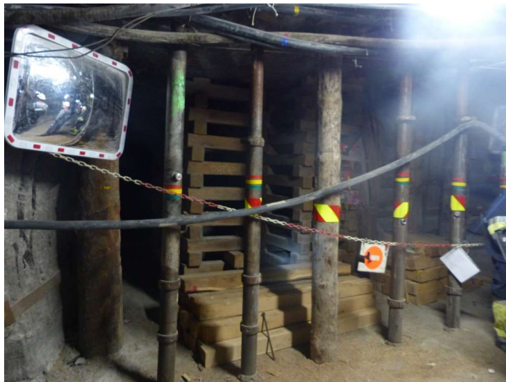
Figure 20 - Recoupe R6 avec un soutènement provisoire avant la mise en place du soutènement définitif
