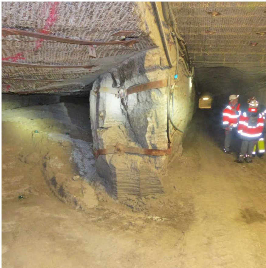
Figure 15 - Etat de déstructuration des piliers
