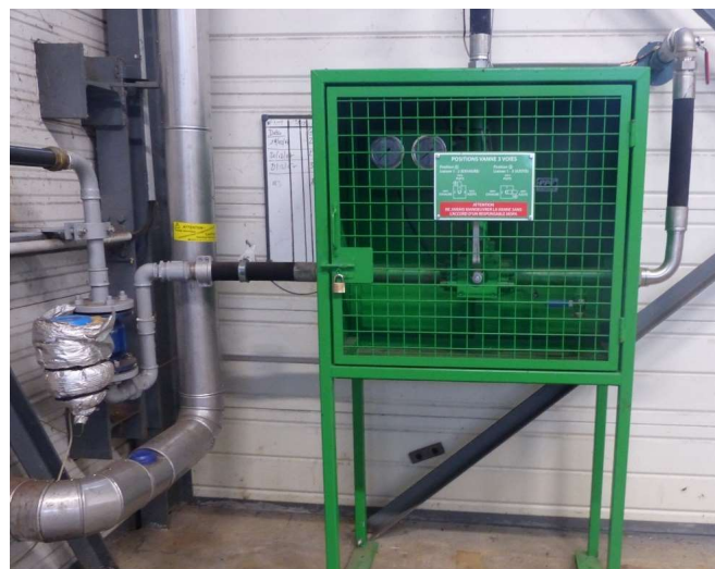
Figure 38 - Tableau by-pass localisé en recette jour (hall C puits Joseph)
