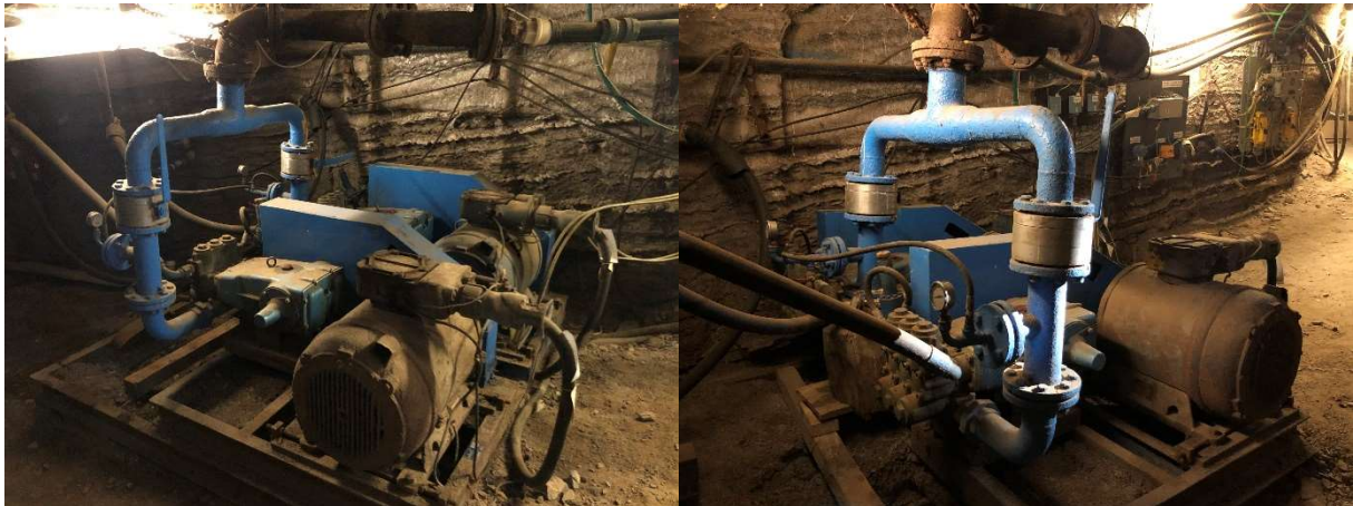
Figure 43 - Photographies des pompes de refoulement vers la surface BARTHOD
