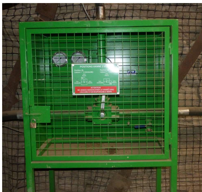
Figure 39 - Tableau by-pass localisé en recette fond (dans la recoupe fluide)
