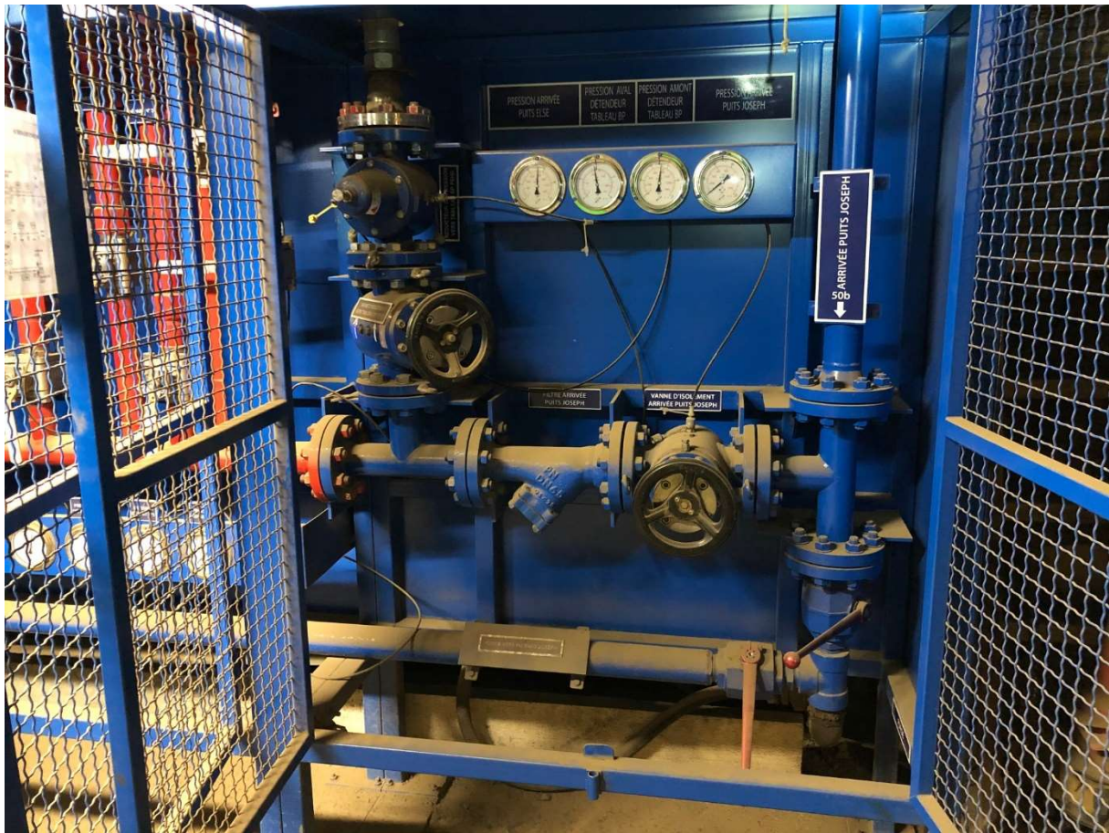
Figure 33 - Tableau divisionnaire avec manomètres de contrôle et réducteur de pression
