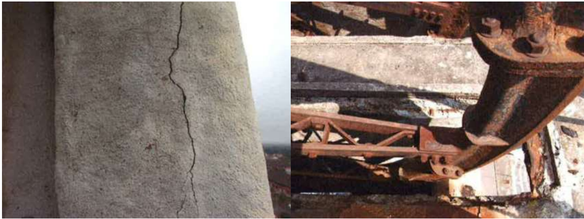
Figure 5 - Etat dégradé des structures béton (à gauche) et acier (à droite) observé durant l'expertise de 2015
