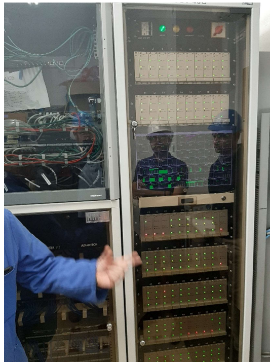
Figure 65 - Photographie de l'installation télégrismétrie en surface (bâtiment Joseph)
