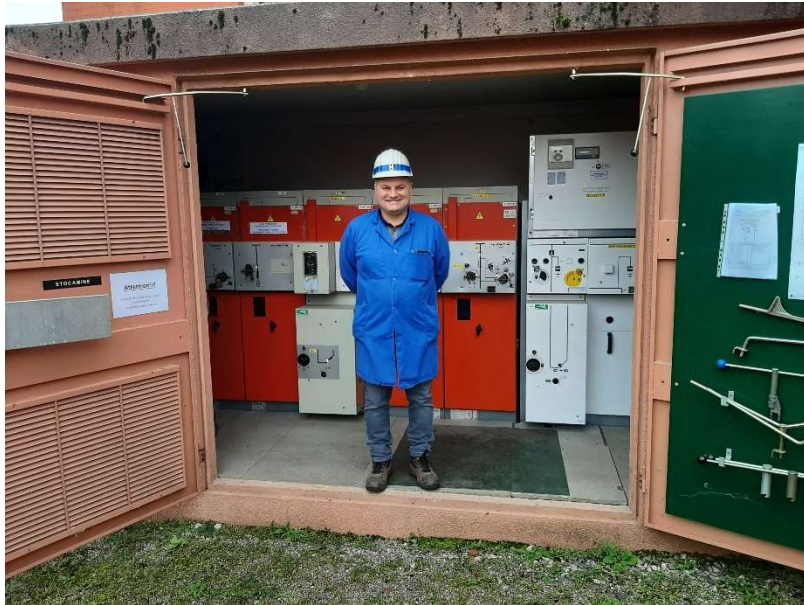
Figure 52 - Poste haute tension des MDPA
