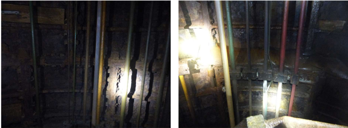
Figure 9 - Photographies de l'état des installations dans le puits Joseph
