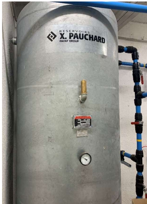
Figure 47 - Photographie de la cuve de stockage d'AC en surface (sous-sol chevalement Joseph)
