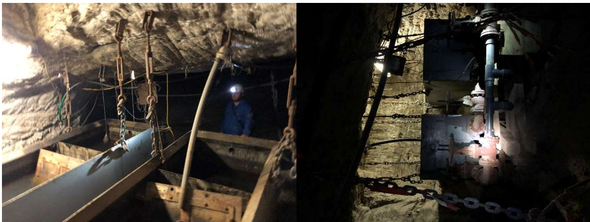
Figure 42 - Photographies des cuves tampon / bacs de rétention
