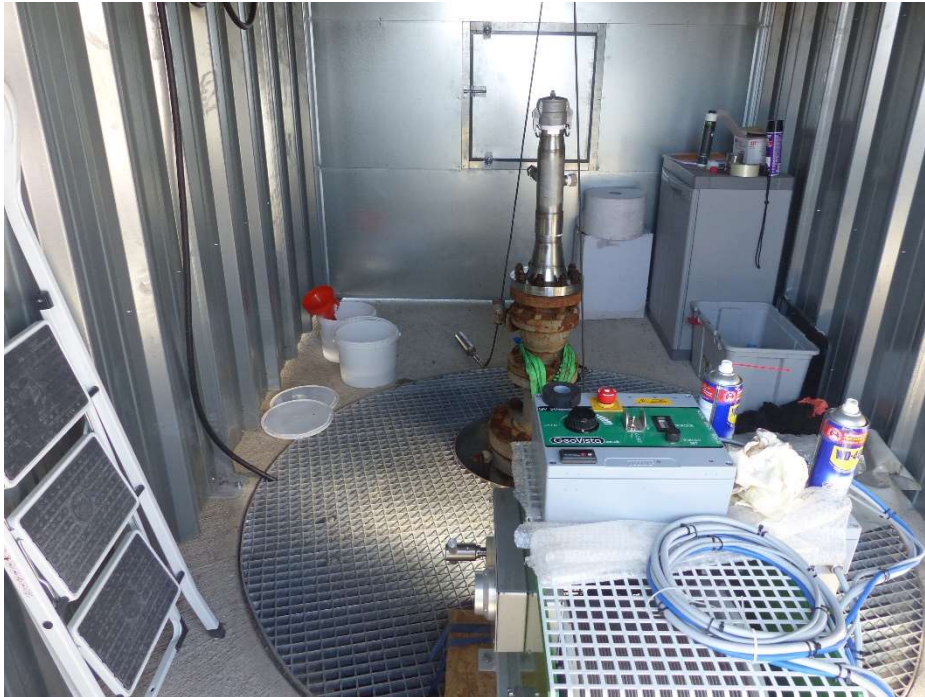
Exemple de local technique sur tête de puits de surveillance avec treuil et capteurs de mesure (puits VLPB2)
