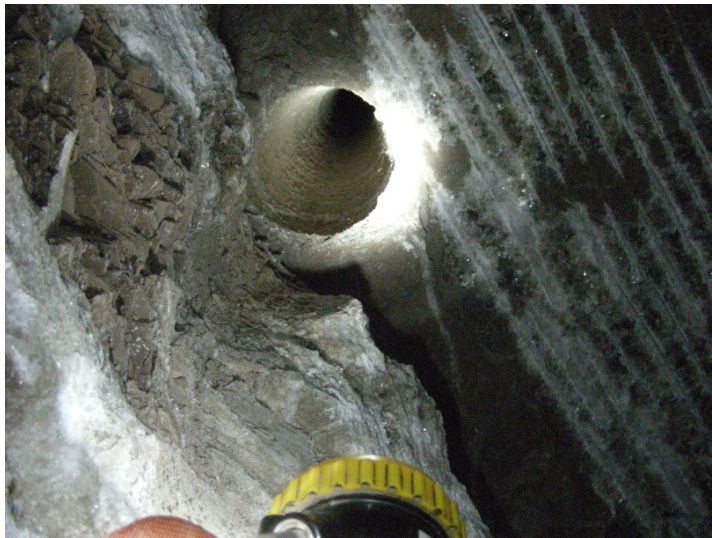
W3 tel qu'il est apparu après havage du toit
