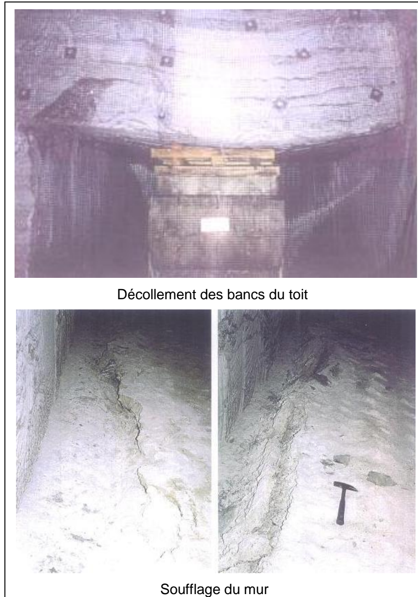
Figure 36 : Instabilités du toit et du mur du stockage de StocaMine, observées in situ
