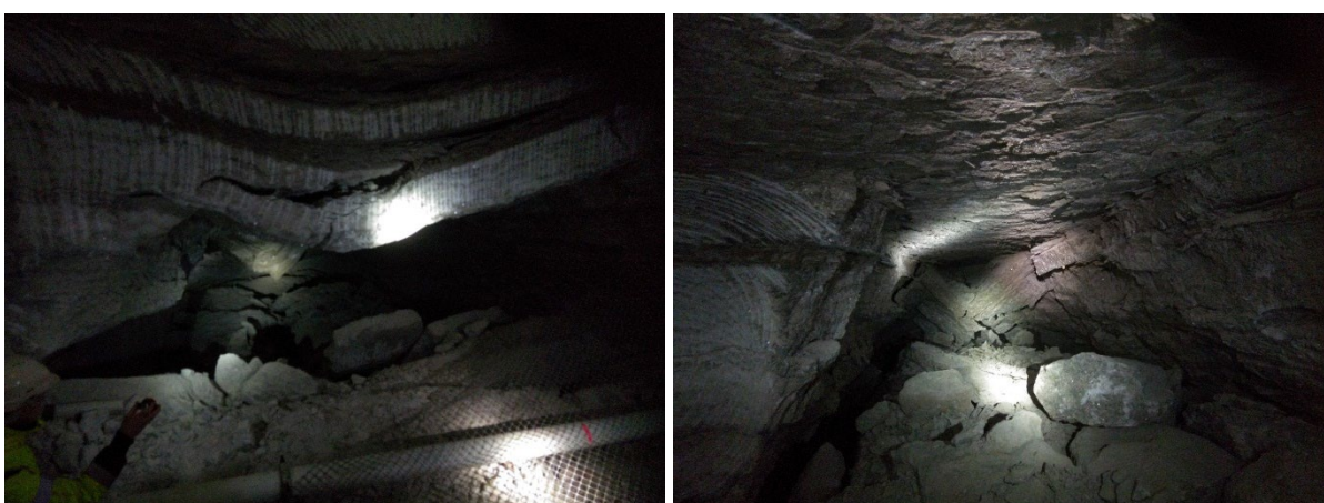
Illustration 6 : Rupture de dalles au toit, bloc 16 – inspection du 10 février 2023
