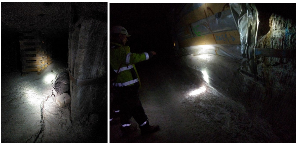
Illustration 5 : Soufflage du radier à proximité du bloc 16 (gauche) et en entrée de bloc 12 (droite) – inspection du 10 février 2023
